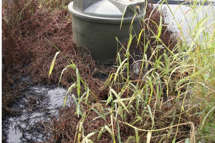
Imagen N°5: Detalle del punto de rebalse de riles desde piscina N° 2
