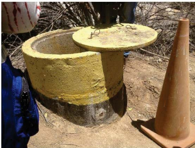
Figura N° 4 – Cámara de inspección de piscina TK-10
