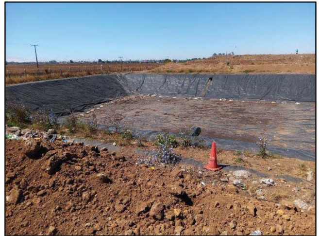
Imagen N° 15: piscina de lixiviados (sistema de manejo de lixiviados) con capacidad de almacenamiento de 20.000 m 3 , vacía.
