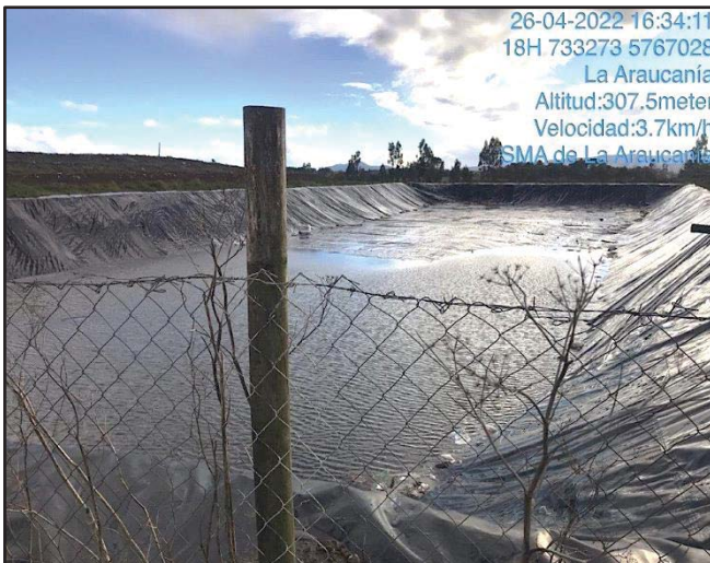
Imagen N° 16: piscina de lixiviados con acumulación de aguas lluvias en sector Este.
