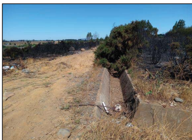
Imagen 13: canal de aguas lluvias sector Oeste Vertedero Victoria obstruido por vegetación, en área Etapa 1 de cierre definitivo.
