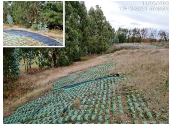
Imagen N° 2: zona Norte del Vertedero Curacautín con geomembrana descubierta y con daños y roturas en diferentes puntos. Fecha: 11/05/2022.
