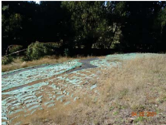
Imagen N° 1: zona Norte del Vertedero Curacautín con falta de cobertura final, quedando expuesta la geomembrana de polietileno. Fecha: 22/04/2021.
