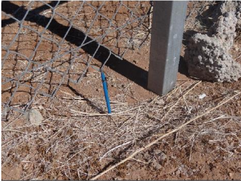
Imagen 5. Cerco perimetral con abertura en base.
