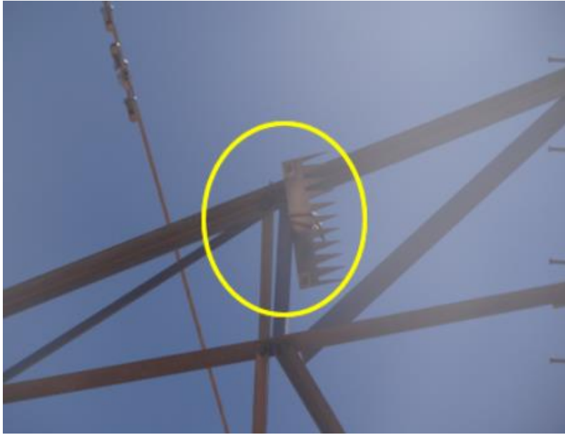
Imagen 3. Acercamiento Torre N° 6, tejado tipo peineta colgando.
