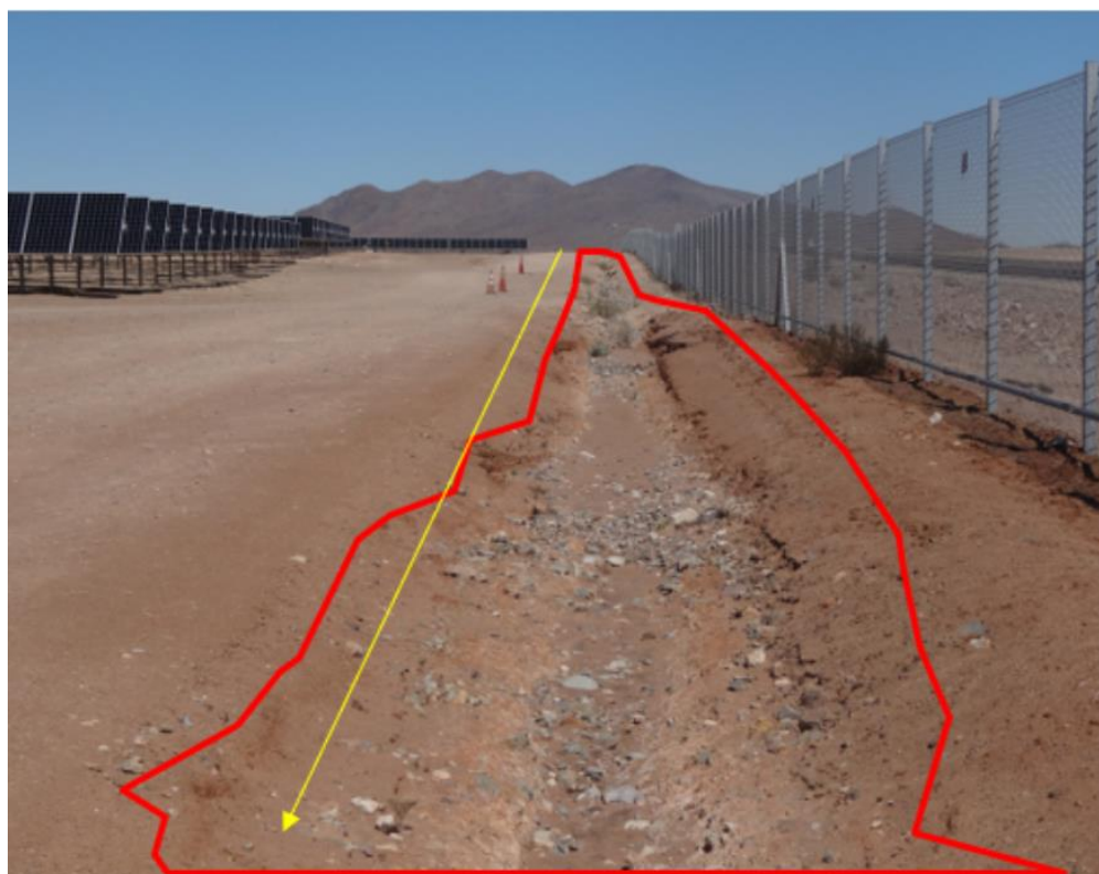
Imagen 10. Tercera vista fenómeno de erosión.
