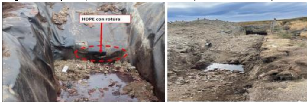
Imagen N°1: Zanja en operación al momento de la inspección del 27 de mayo de 2021.
