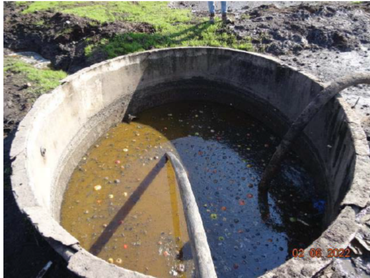
Imagen 8. Estanque de acumulación de lixiviados, con conexión de manguera
