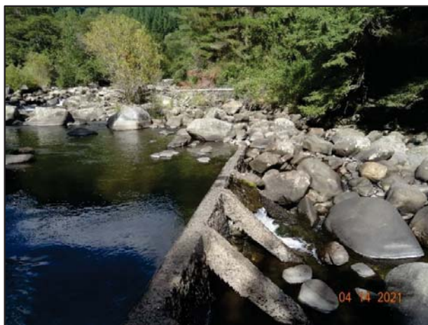
Imagen N° 8: sector bocatoma Piscicultura Curacalco, con escurrimiento de agua sobrante por aberturas y roturas en la barrera, constituyendo parte del caudal ecológico.
