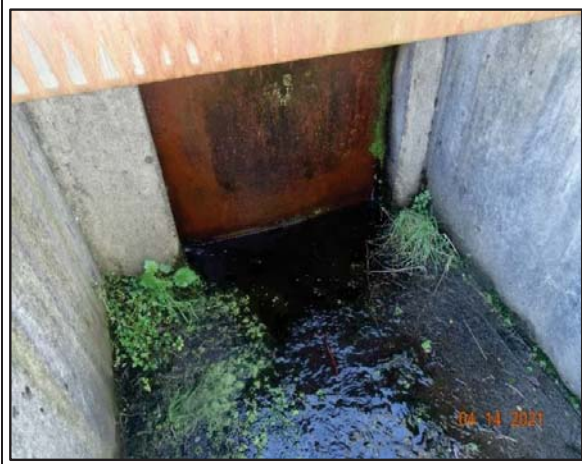
Imagen N° 9: mecanismo de paso de caudal ecológico, consistente en compuerta en obra de bocatoma (cerrada).
