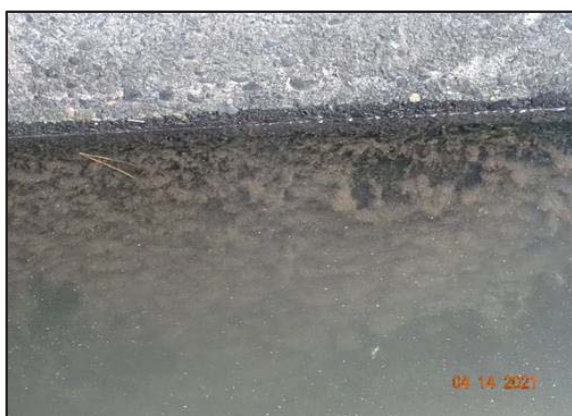
Imagen N° 4: microorganismos en paredes de piscina de decantación.
