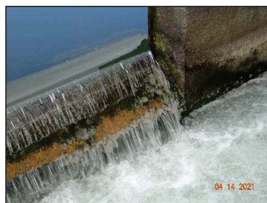
Imagen N° 5: microorganismos en compuerta de piscina de decantación.
