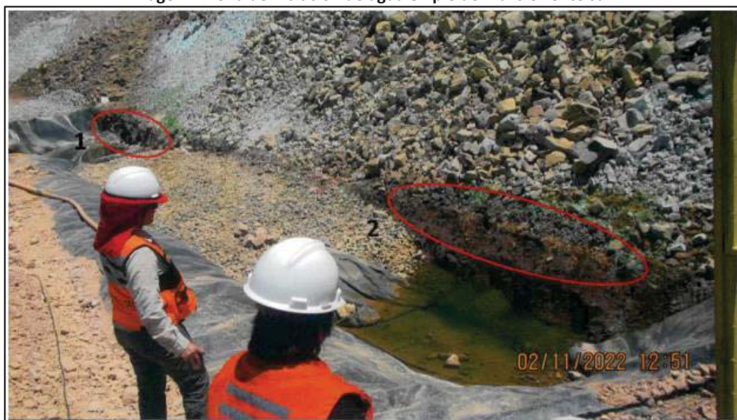
Imagen 1: Zona de filtración de agua en pie de muro oriente sur.
