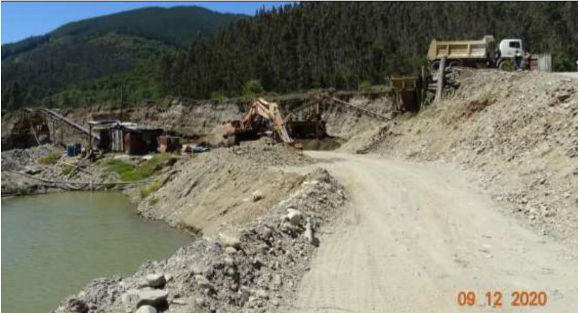
Imagen 6. Constatación de máquina chancadora dentro del predio.
