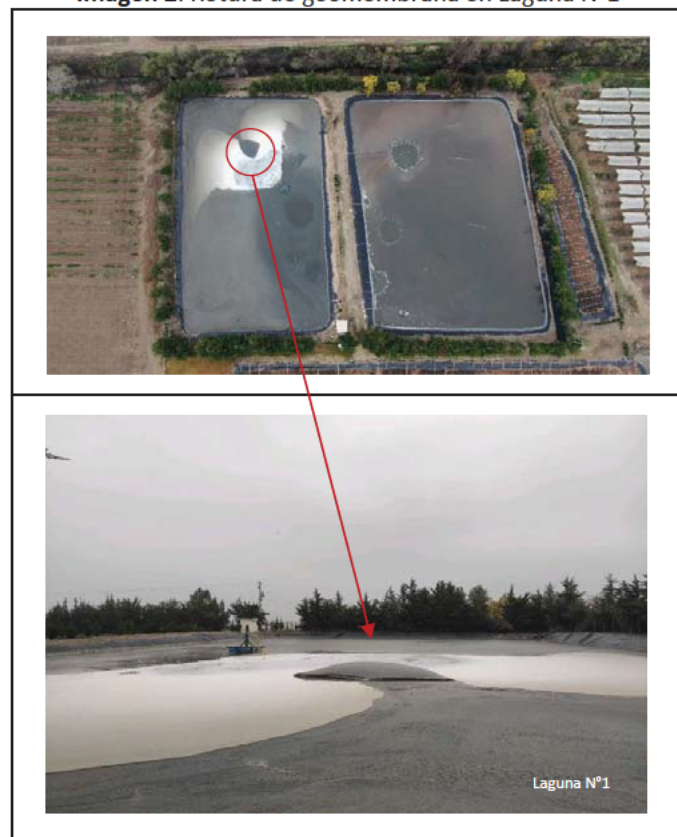
Imagen 2: Rotura de geomembrana en Laguna N°1
