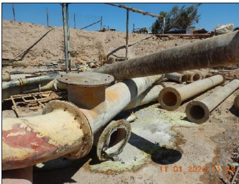
Imagen 5. Tuberías y piso con restos de borra ácida.
