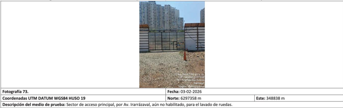
Figura 9. Ausencia de área para lavado de ruedas de vehículos y camiones.
