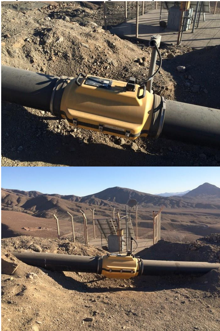
Figura 3.1.- Flujómetro ubicado a la llegada del depósito de relaves Candelaria.
