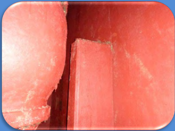
SECTOR BOMBA CIRCULADORES, 2014
