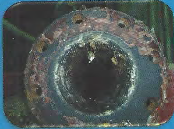
Línea en proceso de limpieza
