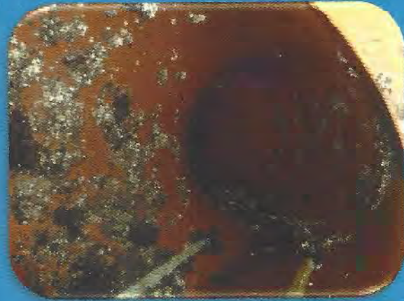
DUCTO CIRCULACION PRINCIPAL 2014
