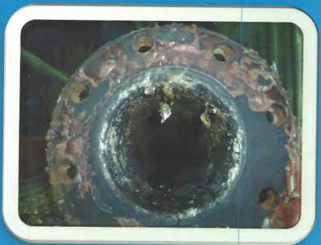
Línea en proceso de limpieza
