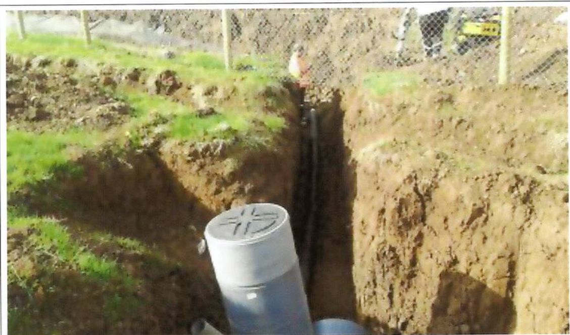
Foto 6. Fosa Séptica instalada como sistema de recolección de fluidos.
