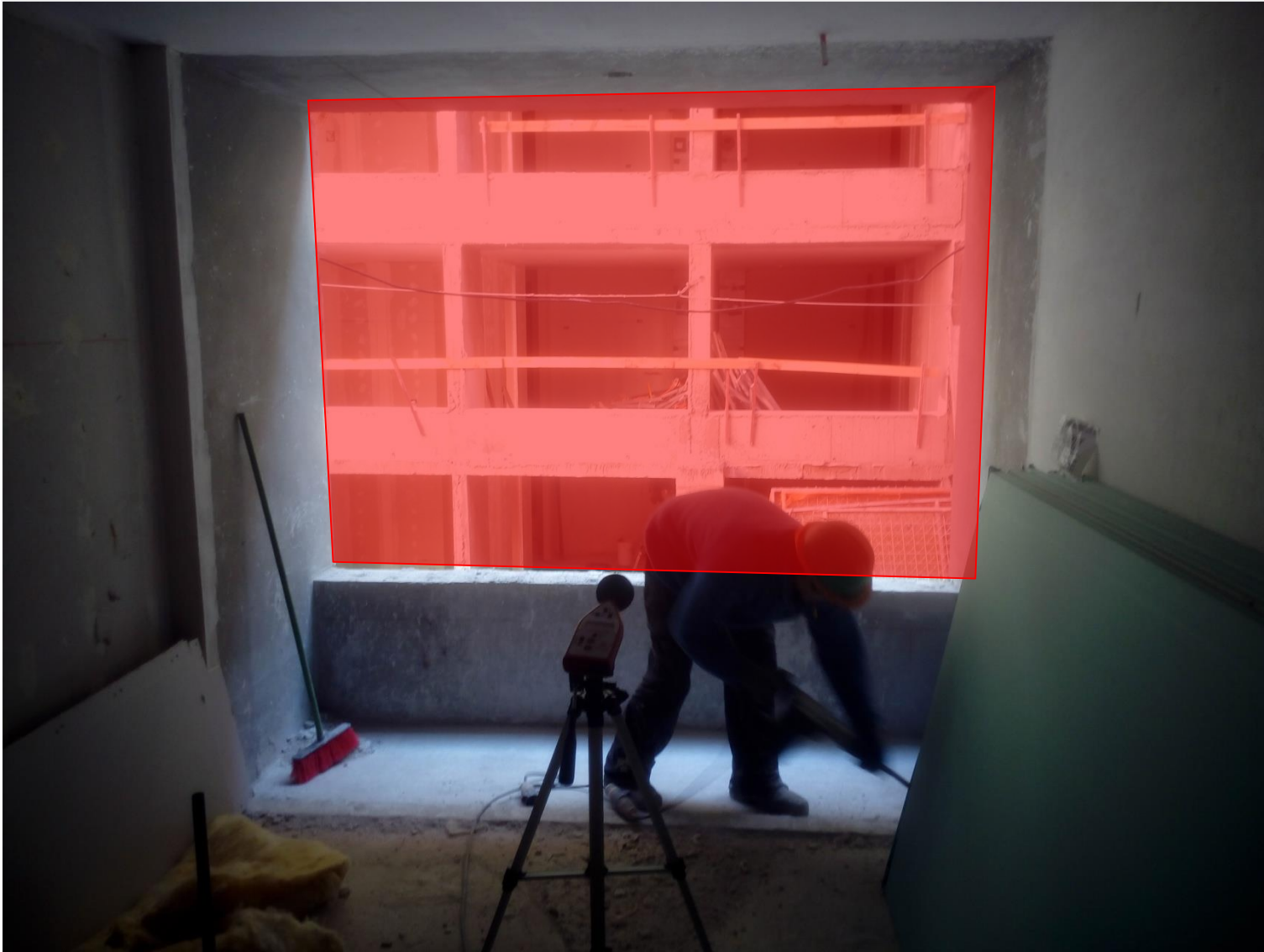
Figura 1. Ejemplo cierre de vanos en los que se realicen trabajos ruidosos con placas de madera OSB
