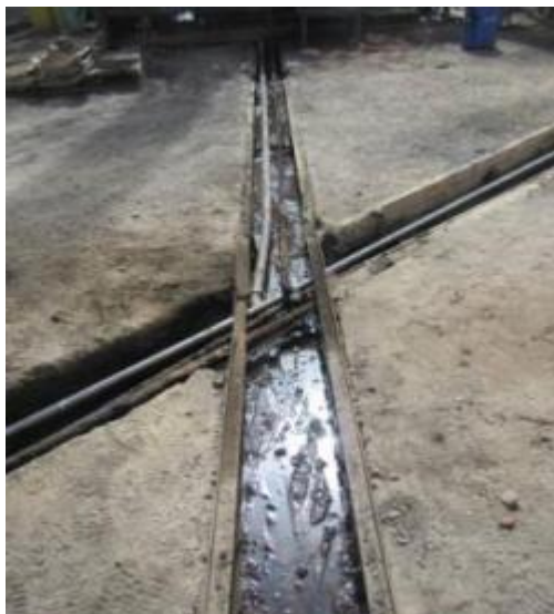
Foto N°1: Canaletas contaminadas con Fuel Oil N° 6
