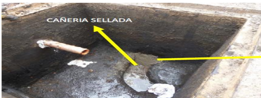
Foto N° 11: Sello de tubería de alcantarillado que unía sistema de recirculación de los Calentadores Electrolitos
