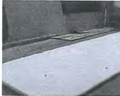
Figura 2 – Vista del montaje del manto de poliéster sobre el piso de la cámara.
