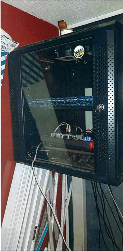
N°1 – Respaldo instalación compresor
