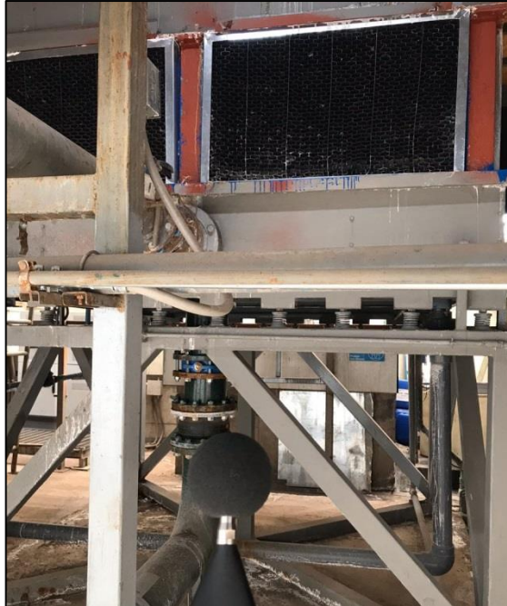
Figura 5.2 Torres de enfriamiento.
