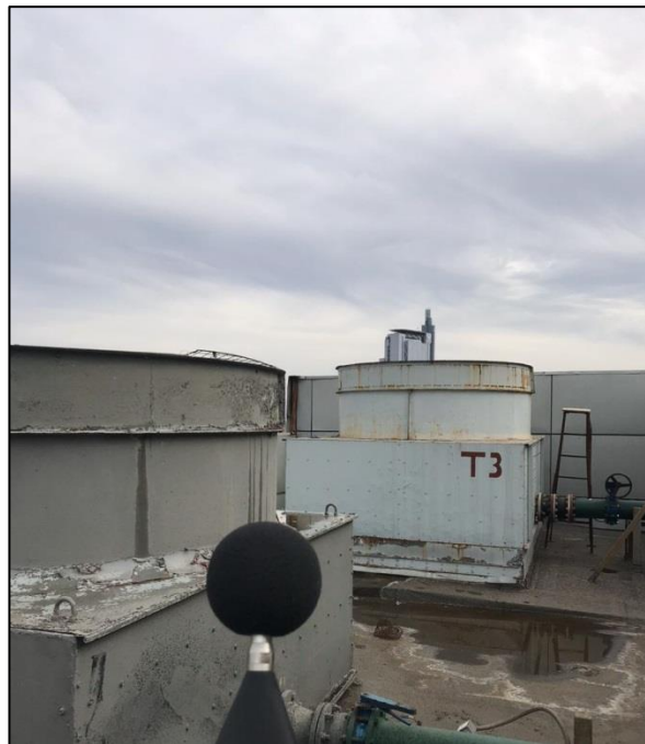
Figura 5.1 Ventiladores torres de enfriamiento
