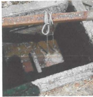
Estanque de Homogenización
