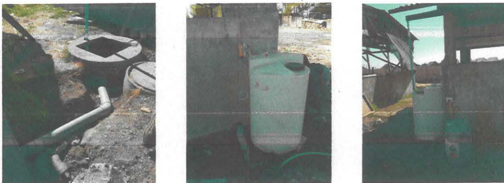
Estanque de Hipoclorito y Bba. Dosificadora.
