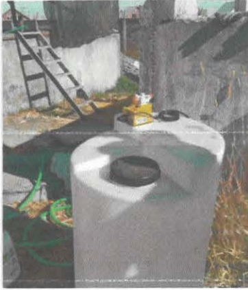
Estanque de Hipoclorito y Bba. Dosificadora
