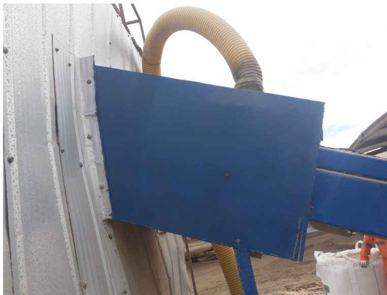
CAPSULA DE CAPTACIÓN DE CINTA TRANSPORTADORA MOLINO REFINADOR Nº 2
