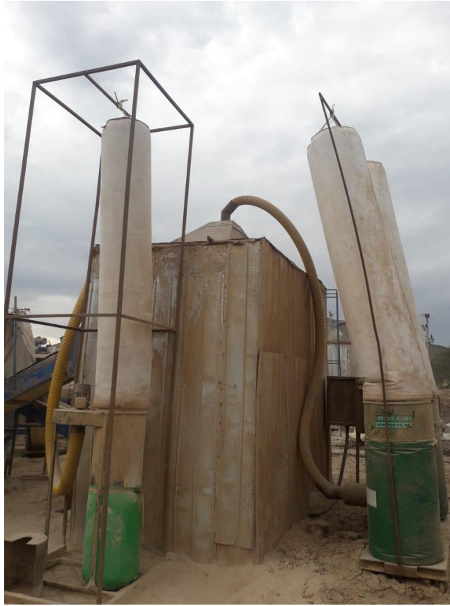
CASETA DE ENCAPSULAMIENTO MOLINO REFINADOR Nº 1
