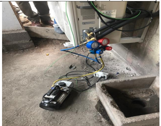
Vacío de circuito de refrigeración
