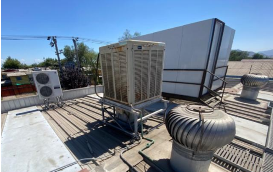
Imagen N°3. Cubierta Supermercado, parrilla de condensadores con apantallamiento acústico.
