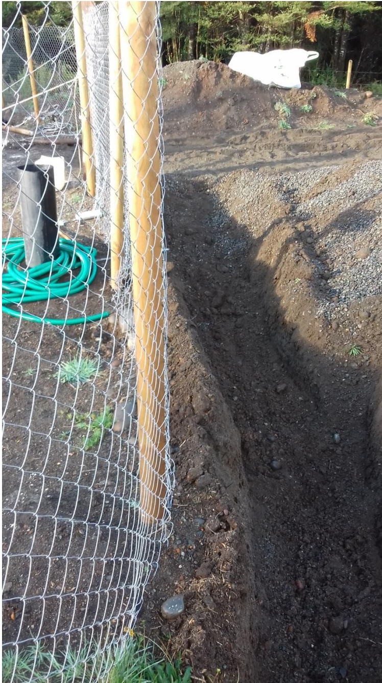
Cámara recolección lixiviado y cuneta agua lluvia pozo 3
