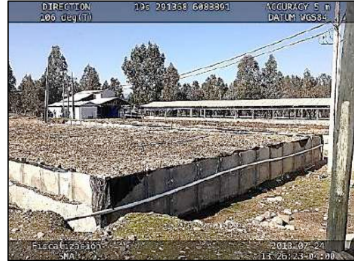
Figura 7. Vista de módulo de lombrifiltro sin techar y sin malla raschel de protección,
