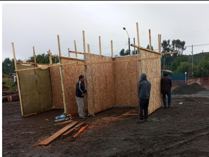
Se evidencia la movilidad de los biombos para ser utilizado en el lugar donde se este trabajando con ruido.
