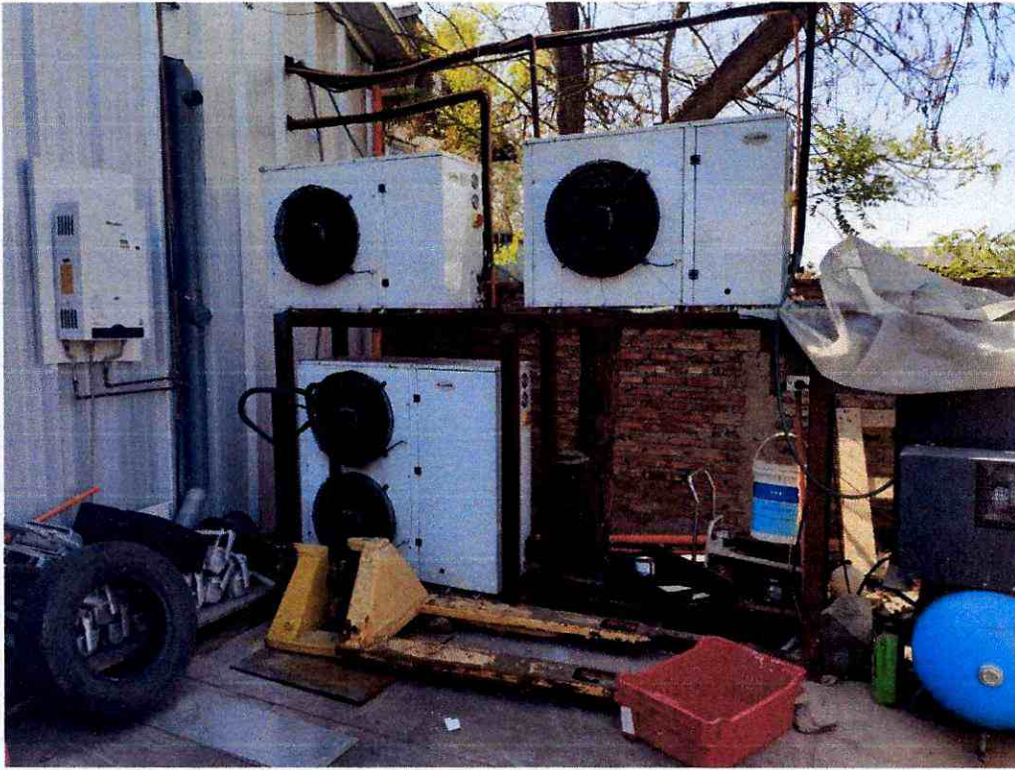
Figura 2: Fotografía de la ubicación de los equipos de ventilación del sistema de cámara de frío.
