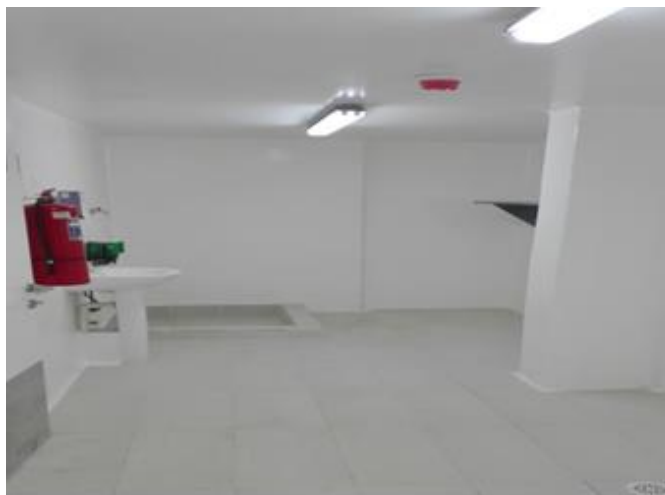
Sala de basura: terminado
