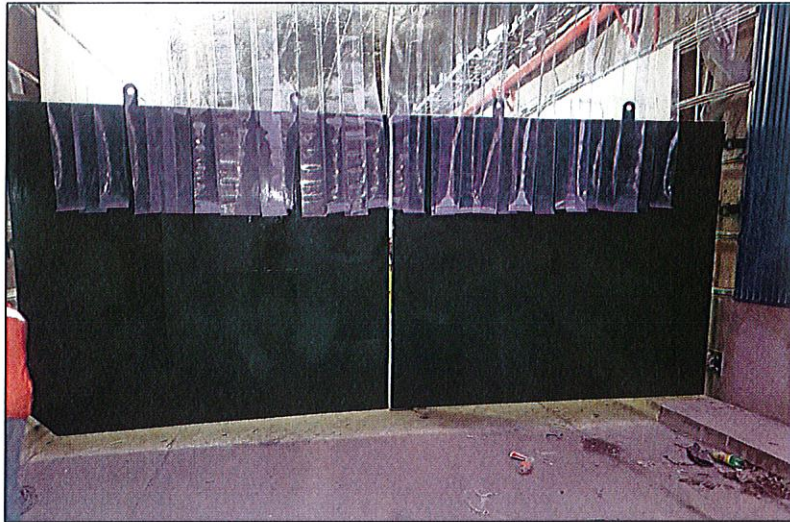
Fotografía 11 Cara externa de portón acústico y cortina superior acústica, en boca del túnel Cuenca.
