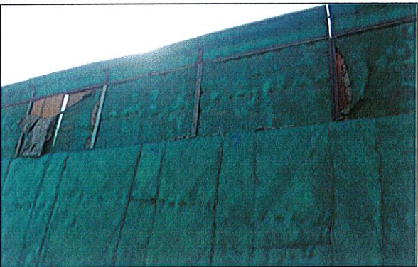
Fotografías 3 Cara interior paneles oriente rampa Cuenca, deteriorados al 27.05.2021
