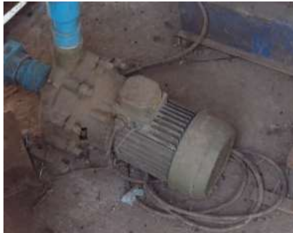
Imagen N° 12 – Bomba de Riego
