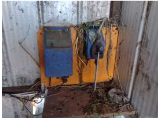
Imagen N° 9 – Controlador PH y Bomba Dosificadora
