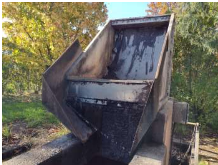
Imagen N° 3 – Filtro Parabólico en Operación
