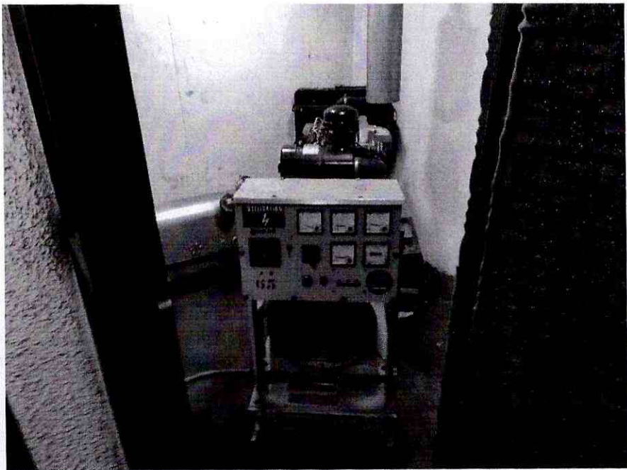
Figura 1: Fotografía del generador de energía de Comunidad de edificio Plaza Suecia.
