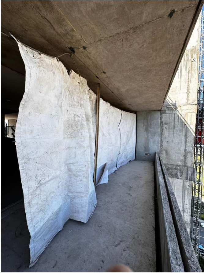
Foto barrera acústica
