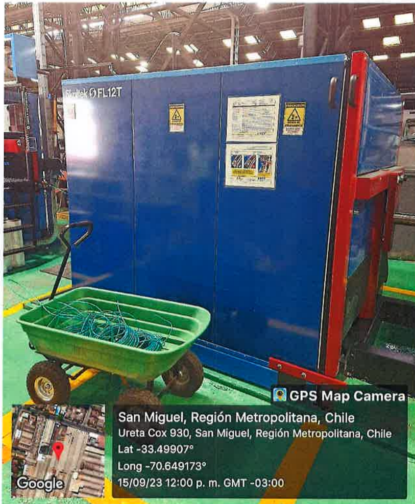
Ilustración 17. Cabina de protección acústica máquina 409
