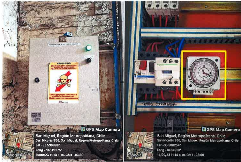
Ilustración 19. Ubicación temporizador (recuadro amarillo) tablero eléctrico torre de enfriamiento
