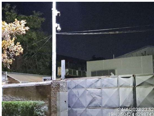
Ubicación de equipos de aire de la Unidad Inspeccionada
