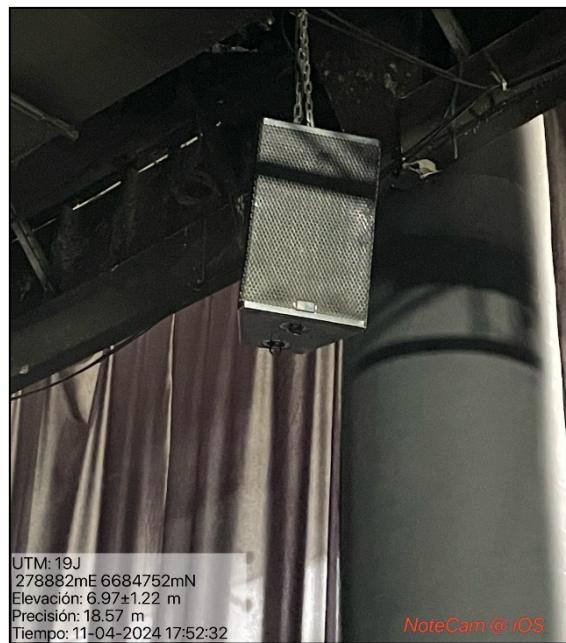
Fotografía georreferenciada y fechada de los dispositivos instalados en sectores S3 y S4:
