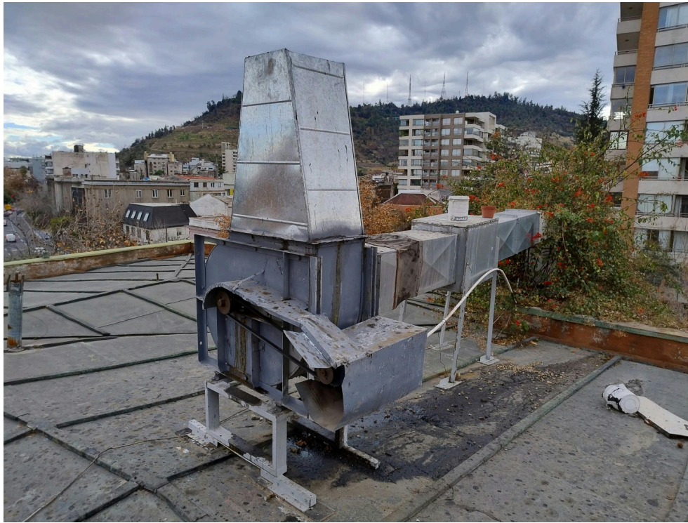
Figura 5: Fotografía de sistema de ventilación instalado en azotea de edificio donde funciona el local “La Antojería”.
