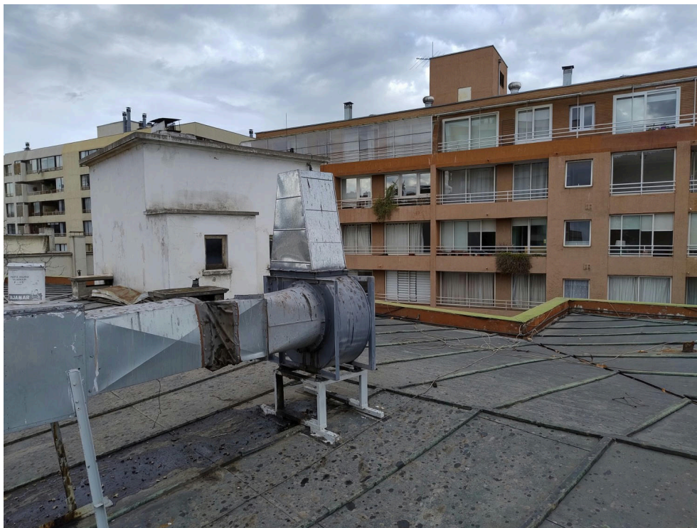
Figura 6: Fotografía de sistema de ventilación en azotea. De fondo, edificio donde se reporta la denuncia.
