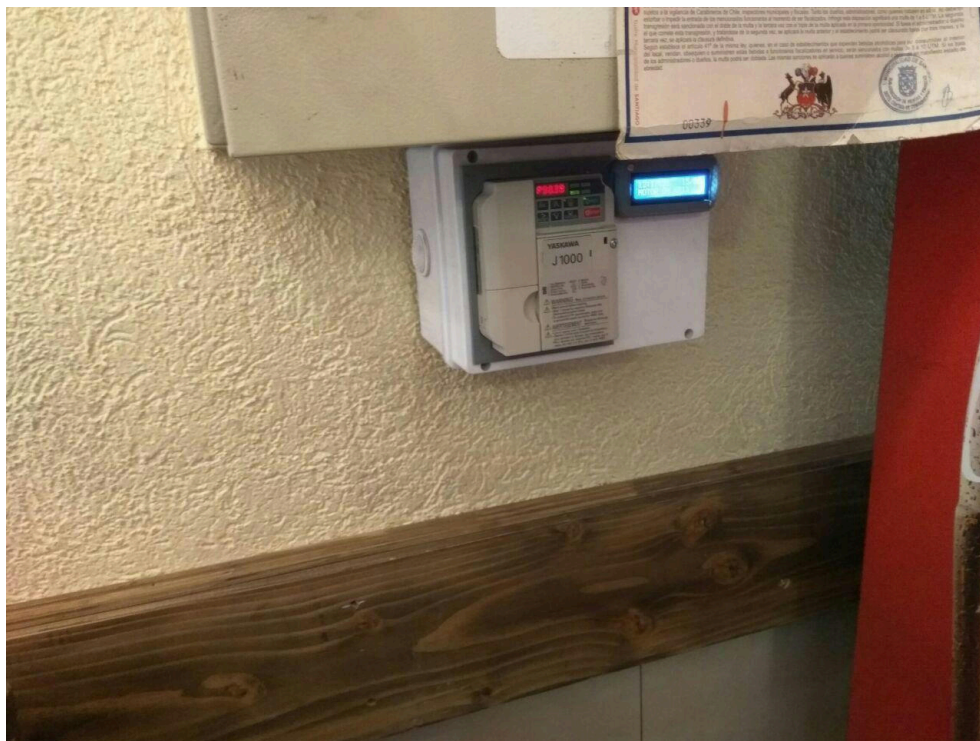
Figura 4: Fotografía de muestra del sistema para control de ruido de extracción a instalar en el local “La Antojería”.
