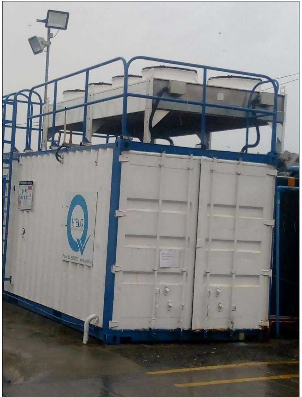
Antes, condensadores de hielo N°2 sin paneles de mitigación de ruidos.
