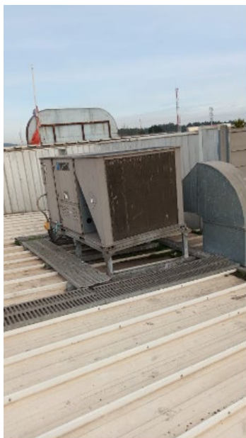
3 equipos rooftops 120x110
