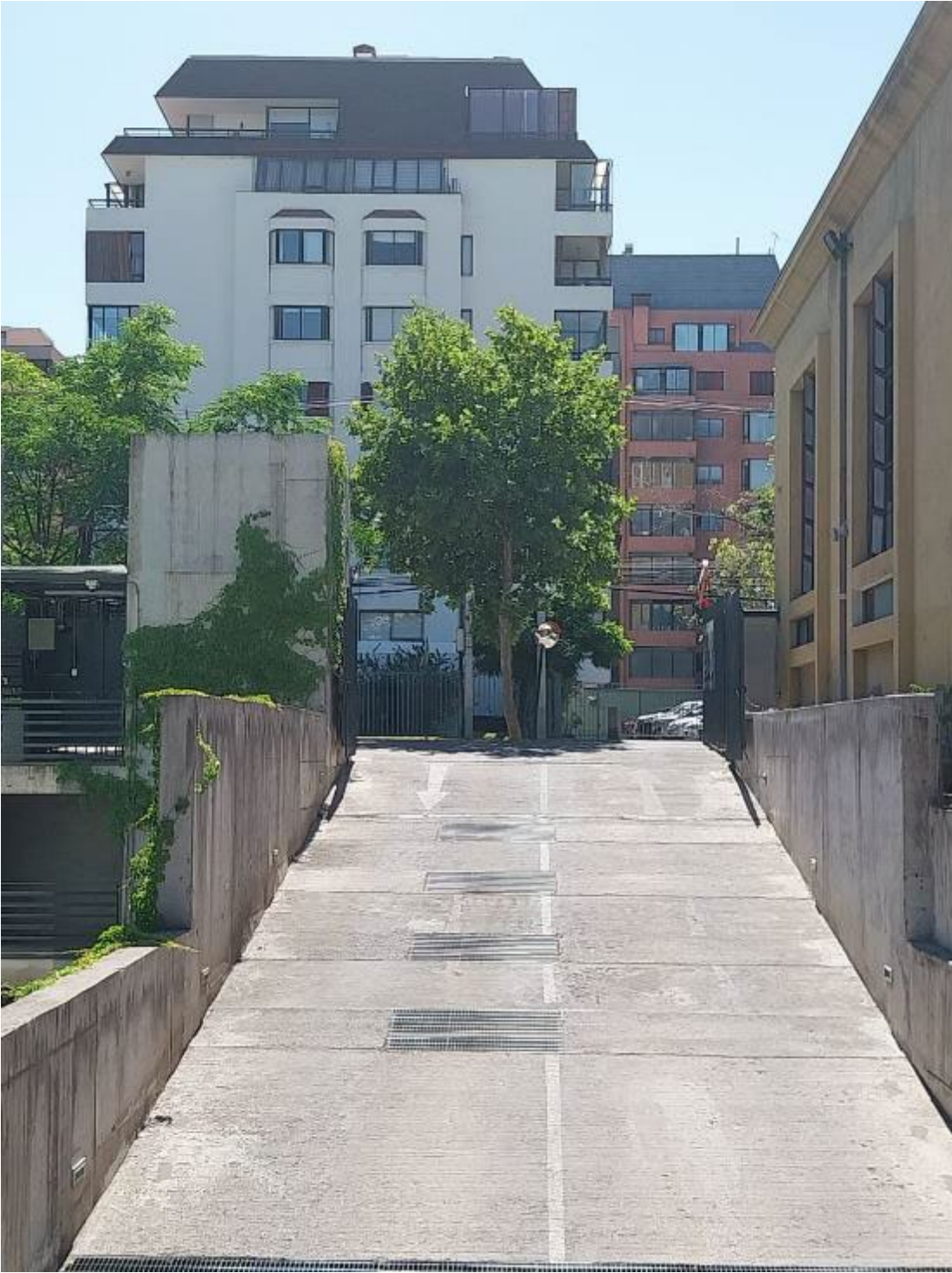
Fotografía N°2 Vista de salidas de aire desde el poniente
