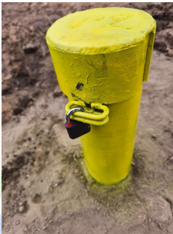
5. Candado de protección para pozo profundo.
