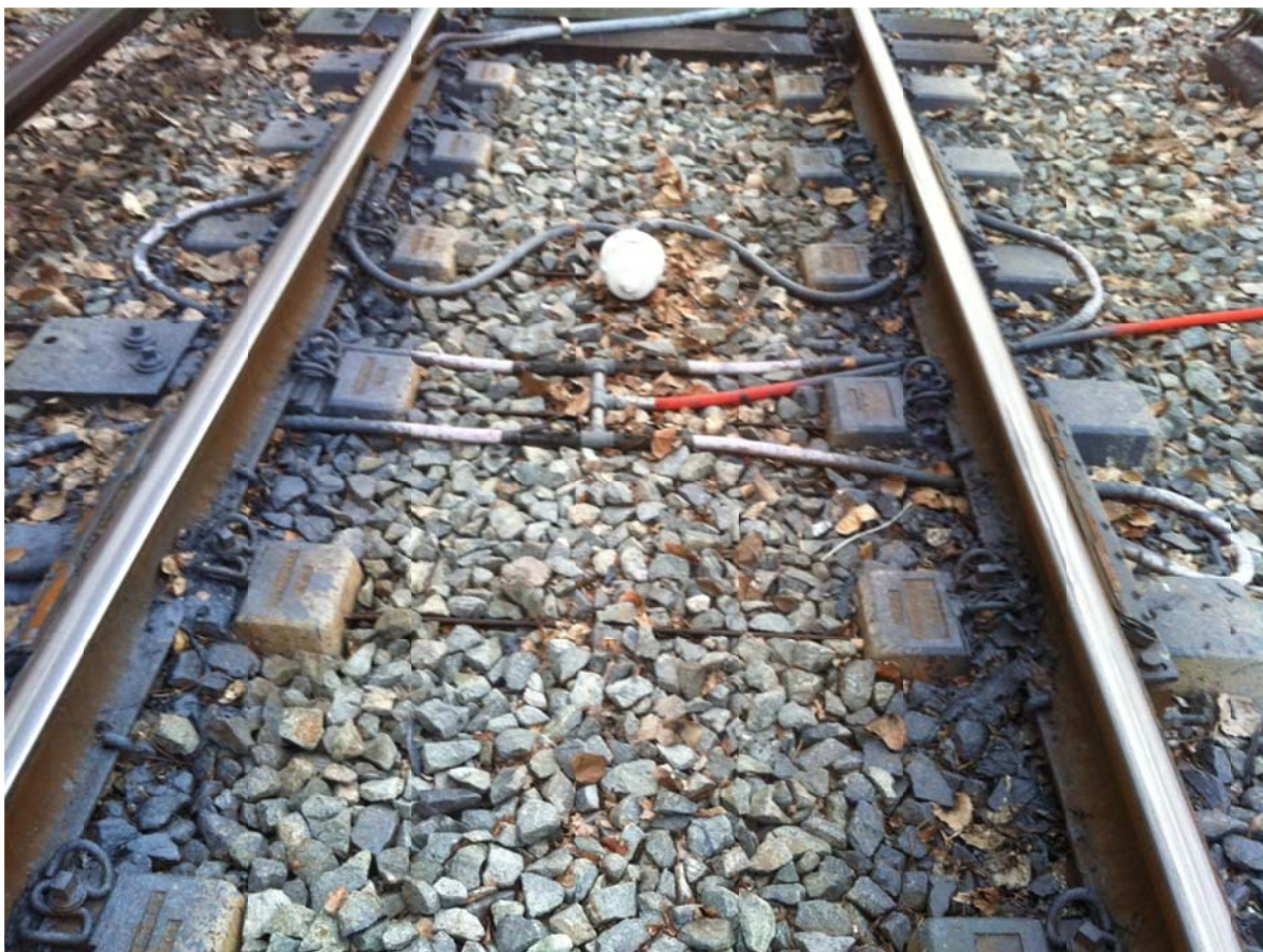
Fotografía N° 3. Máquina de lubricación estacionaria de Keltrack y sistema de distribución.
