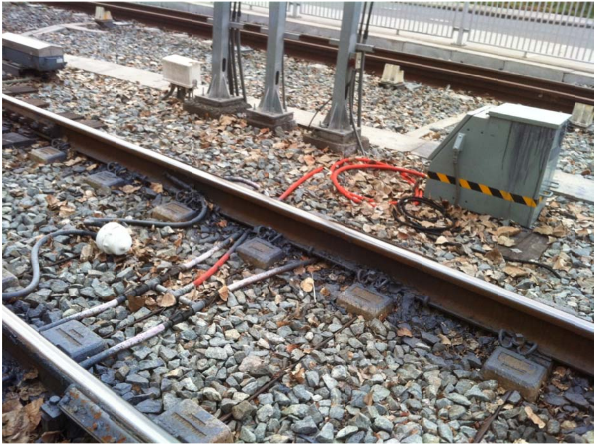
Fotografía N° 2. Máquina de lubricación estacionaria de Keltrack y sistema de distribución.
