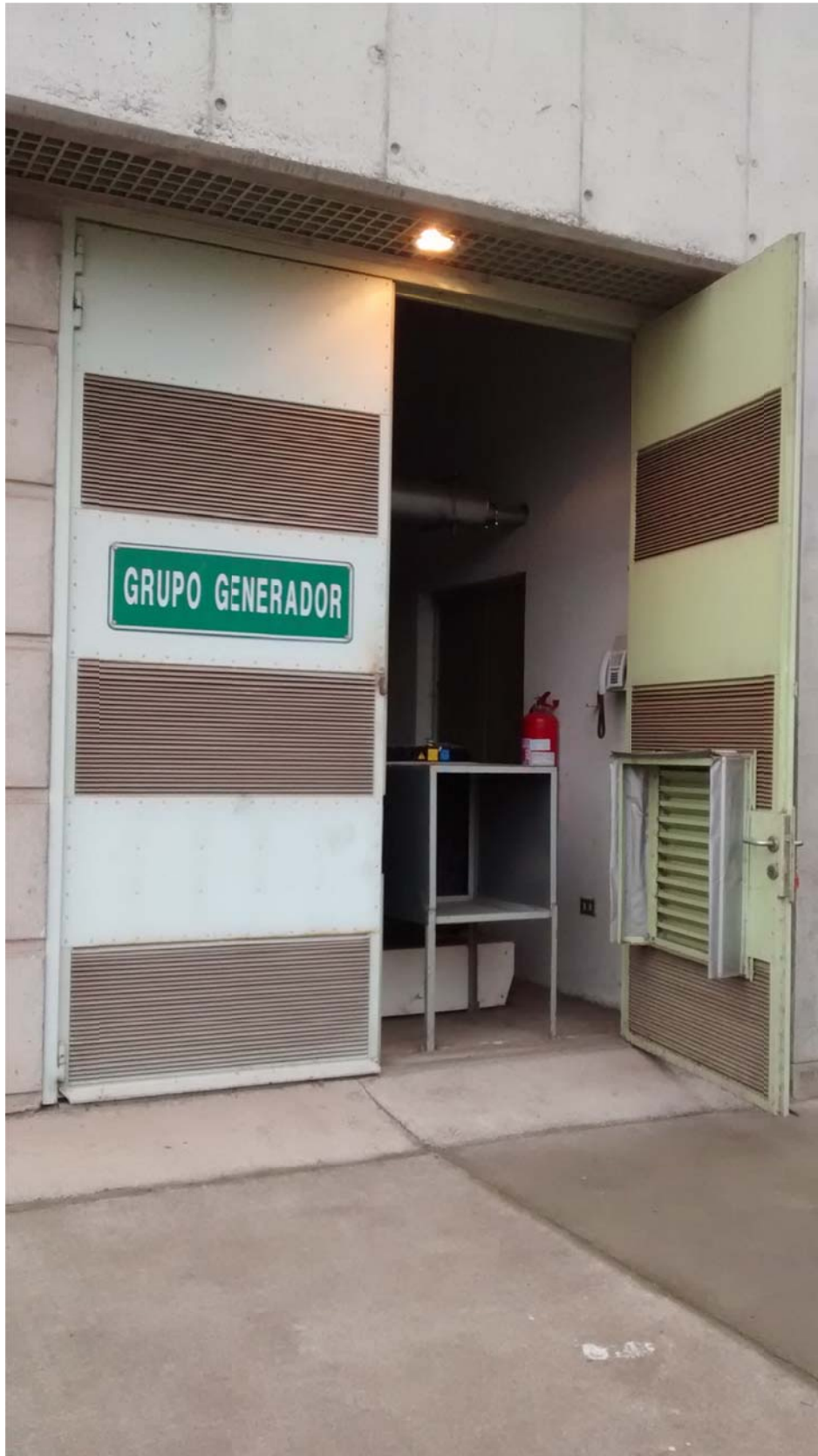
Fotografía N° 2. Recinto con ubicación grupo electrógeno.
