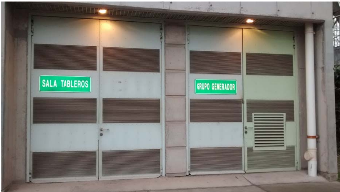
Fotografía N° 3. Recinto con ubicación grupo electrógeno.
