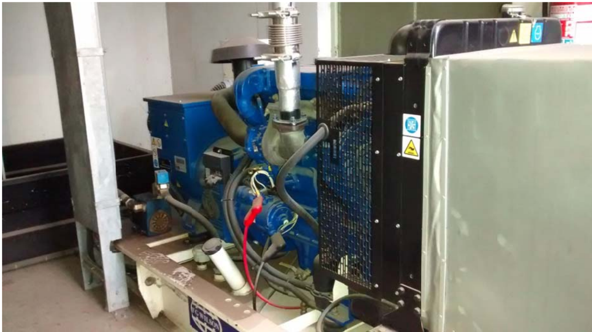
Fotografía N° 4. Vista interior grupo electrógeno.
