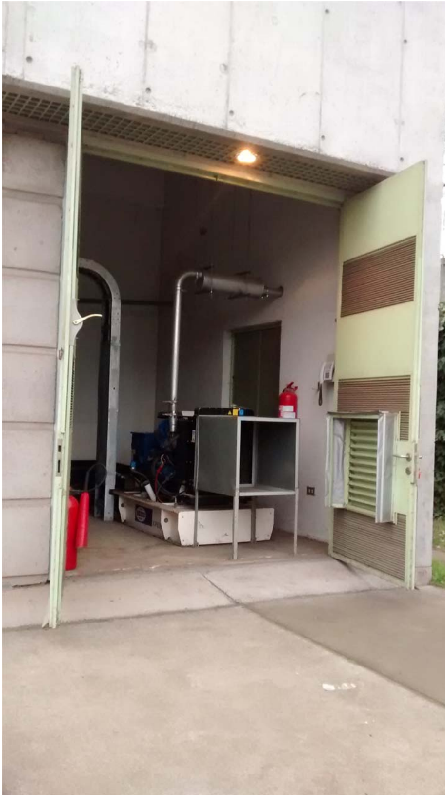
Fotografía N° 1. Recinto con ubicación grupo electrógeno.
