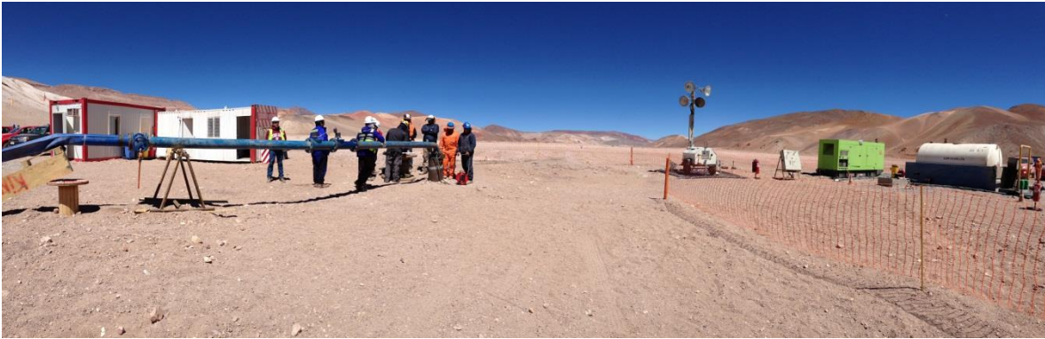
Figura 10: Plataforma de prueba de bombeo en el pozo RA-3
