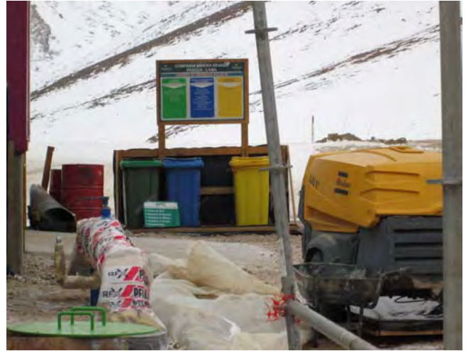
Fotografía N° 24 Sector Planta de Tratamiento DAR (29-06-2012)
