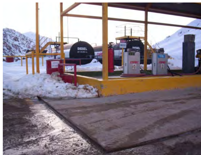
Fotografía N° 12 Detalle sistema de contención de derrames
