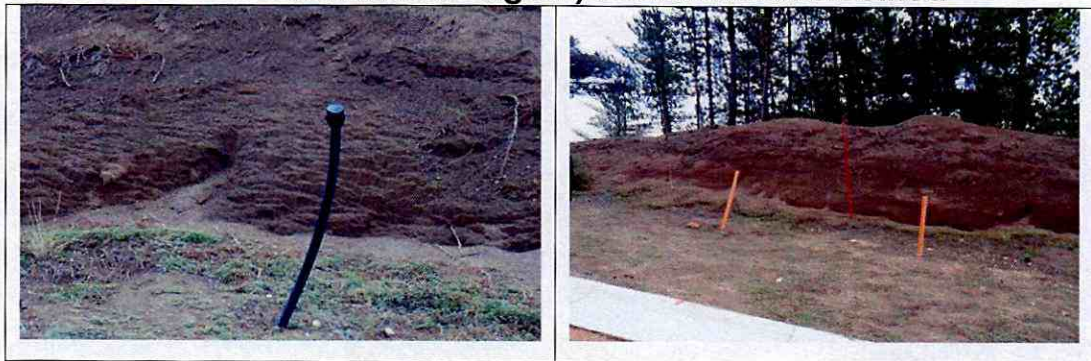
Figura 3 Suministro de agua y canalización eléctrica
