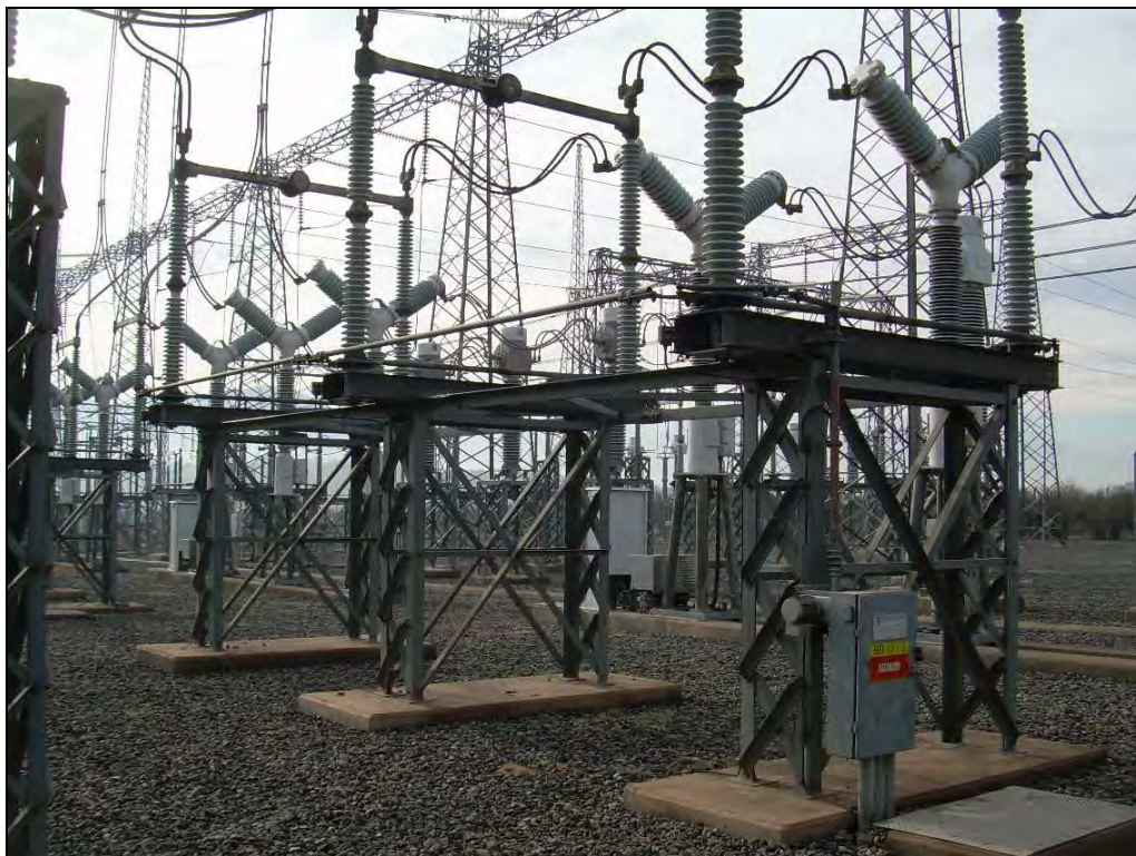
Fotografía 3. Desconectador (89 JS-2) - Merlin Gerin - Paño Seccionador S/E Polpaico.
