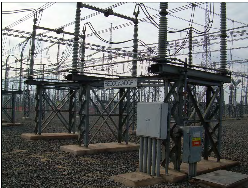
Fotografía 2. Desconectador (89 JS-1) - Merlin Gerin - Paño Seccionador S/E Polpaico.
