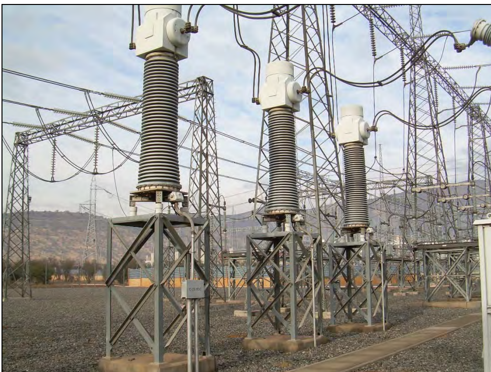
Fotografía 4. Transformador (TC JS) - Balteau - Paño Seccionador S/E Polpaico.
