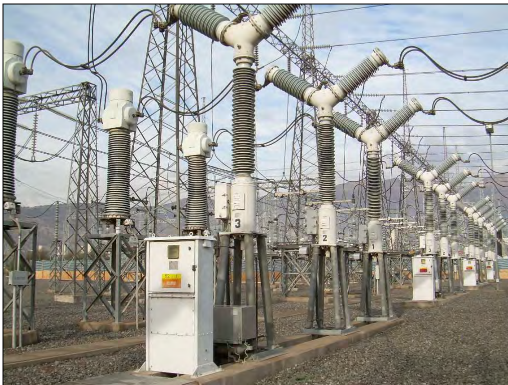
Fotografía 1. Interruptor (52 JS) - Nuova Magrini Galileo - Paño Seccionador S/E Polpaico.
