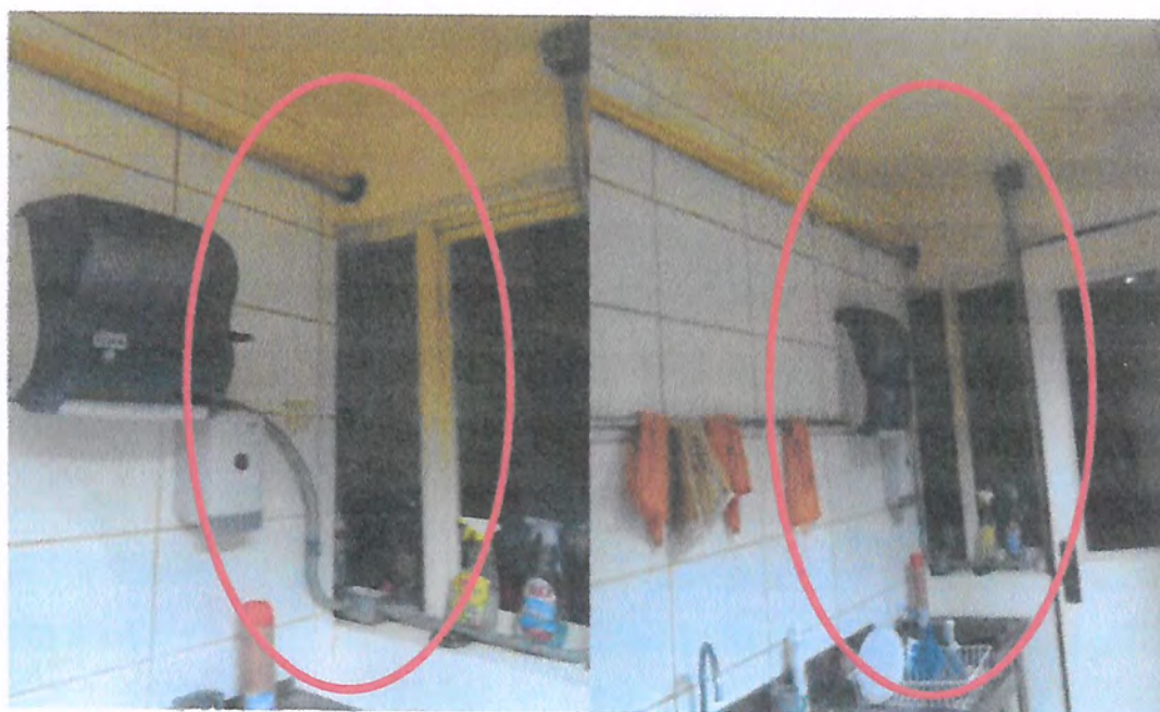
MURO EN SALA DE PREPARACION DE MASAS, SEPARADO VEINTE (20) CMS. DEL MURO MERIMETRAL DE LA CASA VECINA
