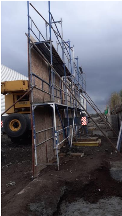
Figura 8. Pantalla acústica instalada a 1 m aprox. de grúa en posición cercano al punto receptor 1.
