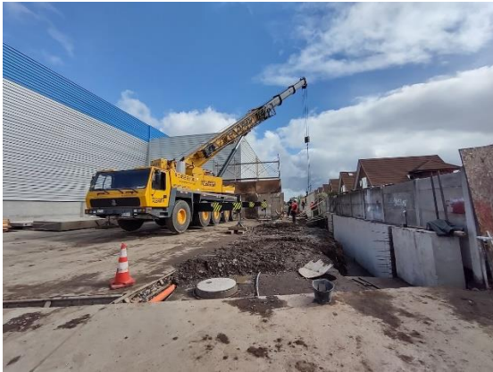
Figura 12. Pantalla acústica instalada a 3 m aprox. de grúa en posición cercano al punto receptor 2.
