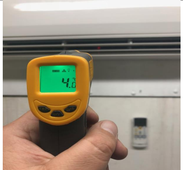
Tº inyeccion equipo 4.0°C
