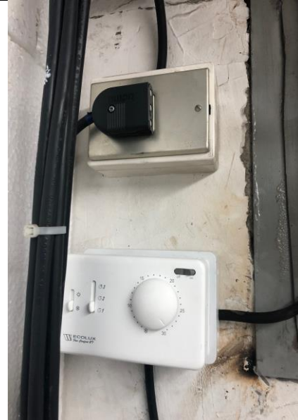
Regulacion de termostato en 30°C, para ventilacion de sala de bateria
