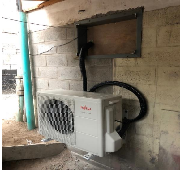
Equipo operando en su etapa de frio
