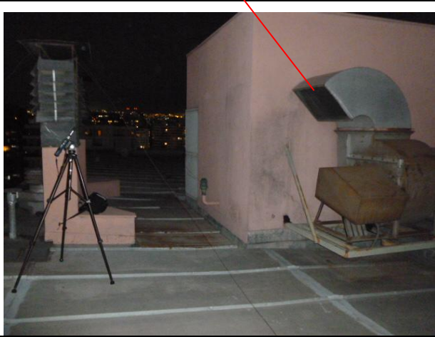
Figura 4.1.3- Extractor Azotea Este
